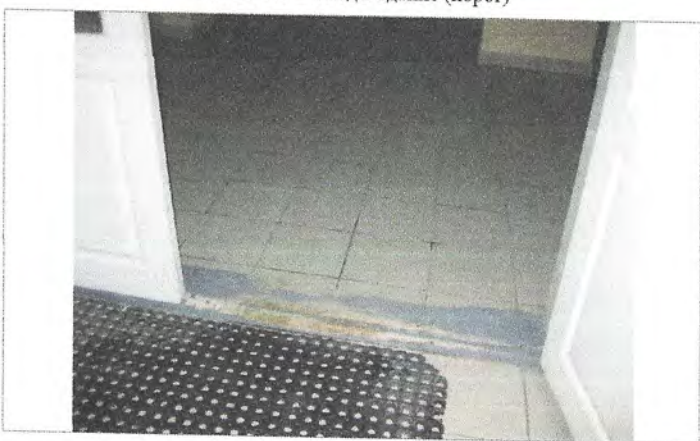
Фото №12 – Вход в здание (тамбур порог)
